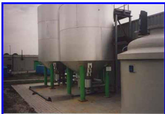
Opstelling van de geïsoleerde "Clarifiers"
