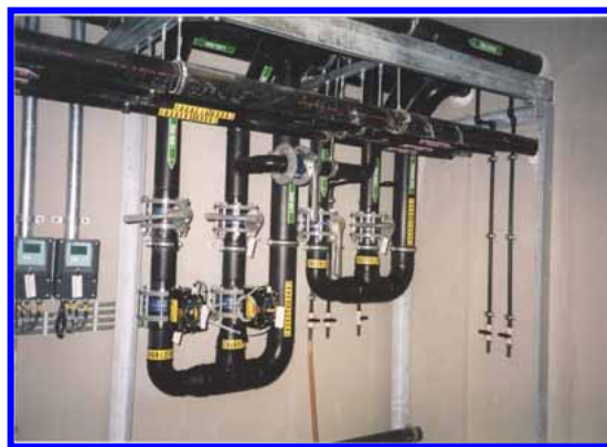
Detail van het leidingwerk
