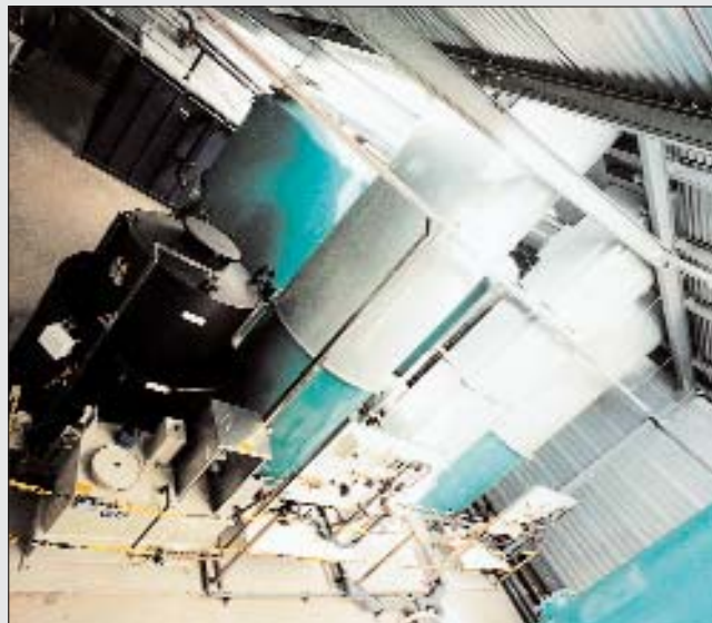
Van links naar rechts de kaliumpermanganaatopslag- en doseerinstallatie met daarvoor geplaatst de aanmaakinstallatie; de twee parallel geplaatste striptorens met daarvoor de doseerpanelen voor pH-correctie met CO 2 .
