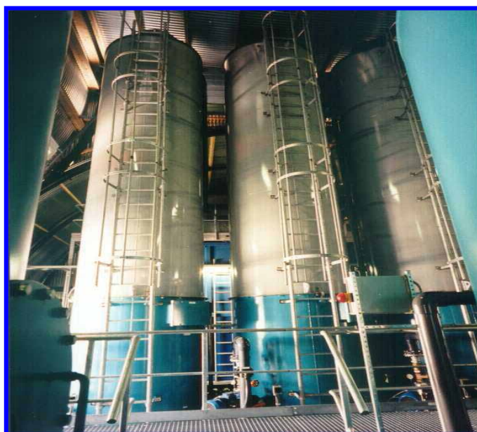
Detailopname van de grondwaterzuiveringsinstallatie
